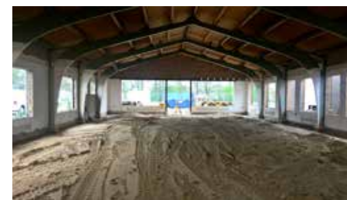
Om de bewoners te laten genieten van de karakteristieke vakwerkspanten worden de brandwerende en woningscheidende wanden tussen deze spanten in geplaatst.
